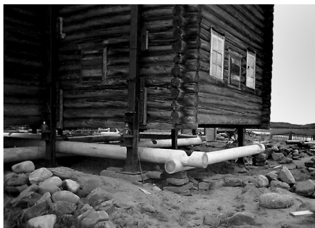
Отрыв здания церкви от земли на 24 домкратах, специально привезенных из Швеции. Замена первого венца. Июнь 2005 года
